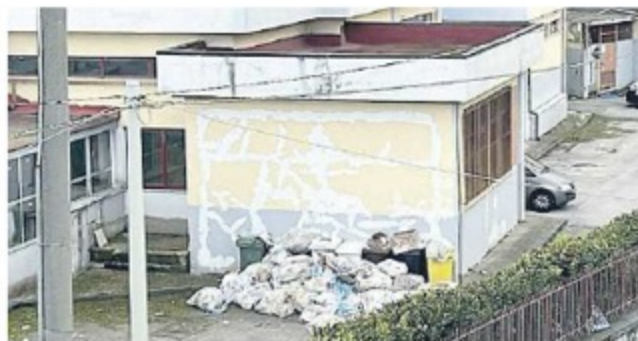
L'ABBANDONO La spazzatura accatastata sotto le aule
